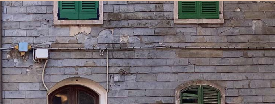
Rivestimento in lastre di ardesia da restaurare
