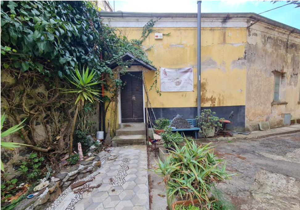
Dettaglio di facciata con pensilina e zoccolatura incongrua
