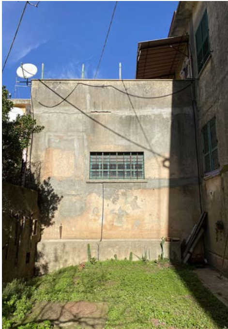
Veduta retro con copertura incongrua
