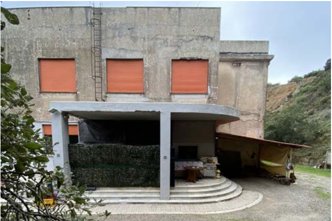
Chiusura incongrua della pensilina e copertura incongrua
