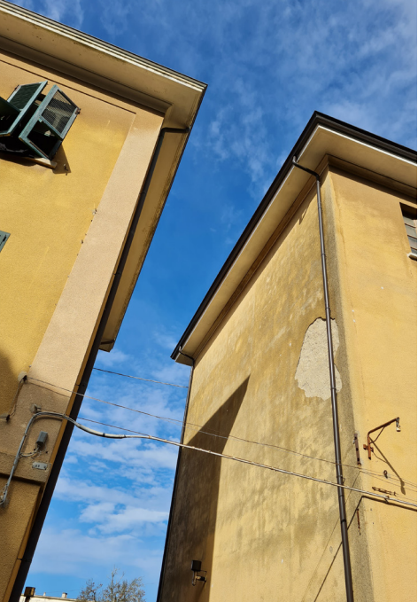
Distacco ta edificio 24 e 25
