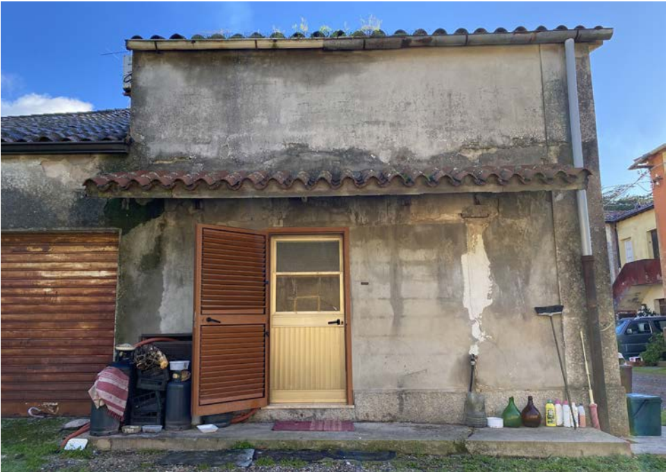
Vista del retro con infisso e oscuramento incongrui
